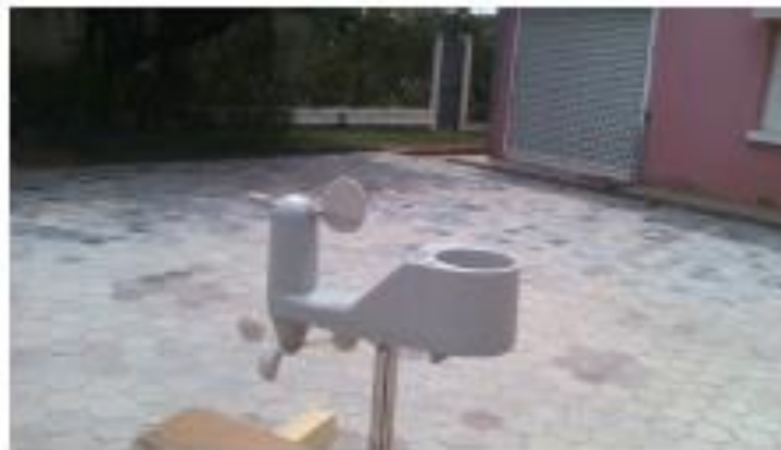
Figure 6 : Installation de mini station météo sur le pavé travertin
